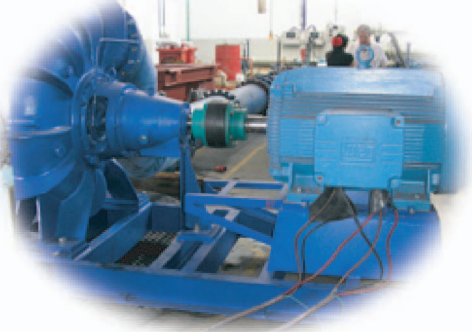
FA 9 en bomba centrífuga
